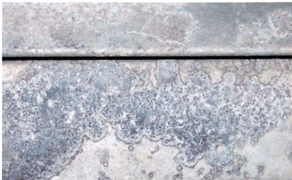
Oblast na žárově pozinkovaném přívěsu, na které se vyvinula bílá koroze, když byl přívěs vystaven posypové soli.
